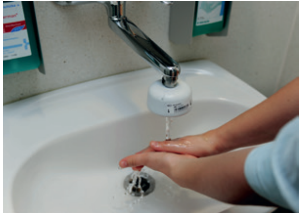
Zu Ihrer Sicherheit sind alle Wasserhähne und Duschköpfe mit Filtern ausgestattet
