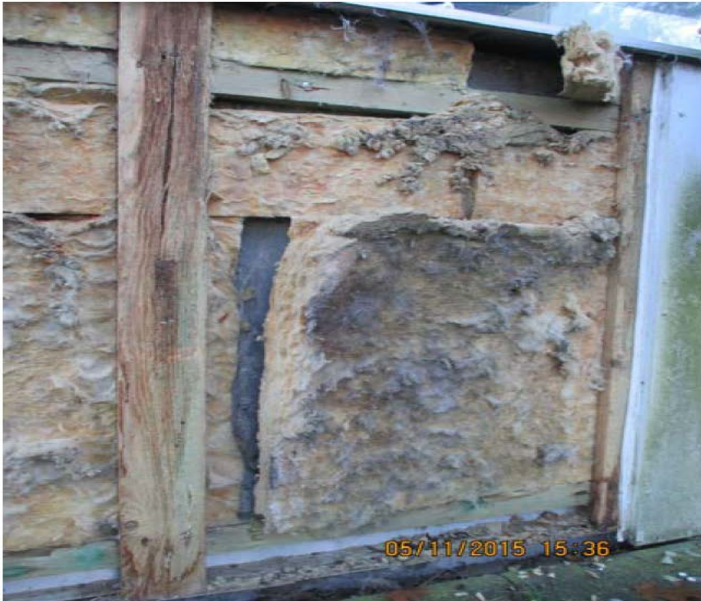
Dämmstoff (KMF) hinter Fassadenplatte weiß, organischer Befall
