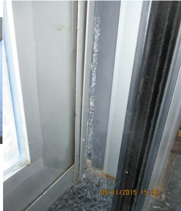
Raum C1.11 Anschlussfuge Fensterrahmen-Betonpfeiler Fugenmasse innen (PCB 4.600 mg/kg) AGROLAB-Prüfbericht Nr. 677898 vom 13.11.2015
