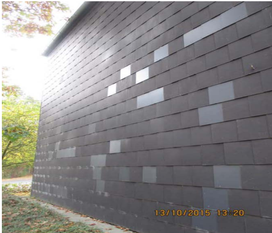
Fassadenverkleidung Kunstschieferschindeln schwarz (Asbest)
