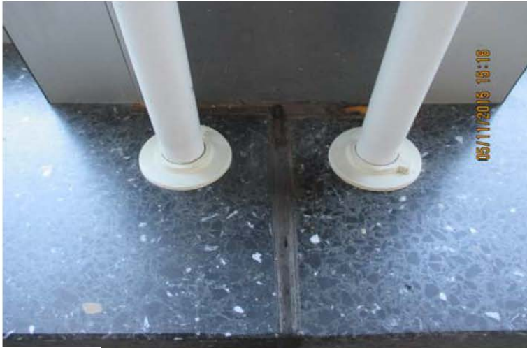
Raum C1.11 Anschlussfuge Fensterbänke - Betonpfeiler Fugenmasse (PCB 7,9 mg/kg) AGROLAB-Prüfbericht Nr. 677899 vom 13.11.2015
