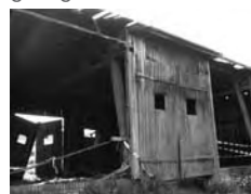
| Zustand der ehemaligen T4-Bus-Garage in Hadamar am 30. September 2003 (Ansicht von der Rückseite)
